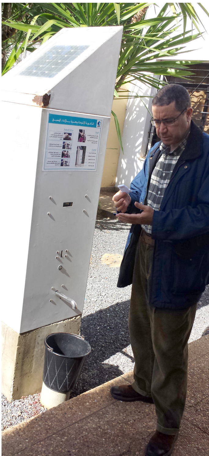
☪ Borne fontaine pour forage à pompage solaire-ONEE
